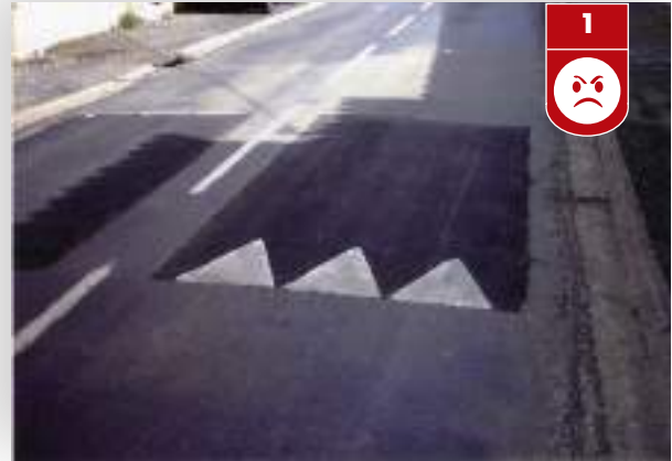
" Zone 30 " avec réducteur de vitesse mais ralentisseur posé trop près du trottoir.
